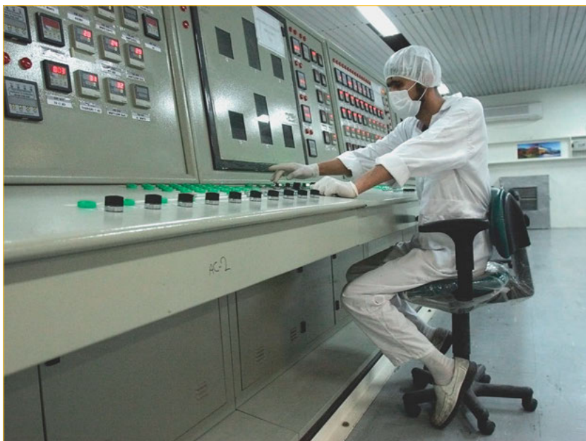
Abb 3 Iranischer Techniker am 3.2.2007 in einer unterirdischen Urananreicherungsanlage in der Nähe von Isfahan, 410 Kilometer von Teheran entfernt. Im Juni 2010 wurde dort das Schadprogramm »Stuxnet« entdeckt. Aufgrund des enormen Aufwands bei der Herstellung des Computerwurms wurde vermutet, dass ausländische Geheimdienste, eventuell aus den USA oder Israel, dieses Schadprogramm entwickelt hatten, um die iranischen Urananreicherungsanlagen nachhaltig zu stören.
